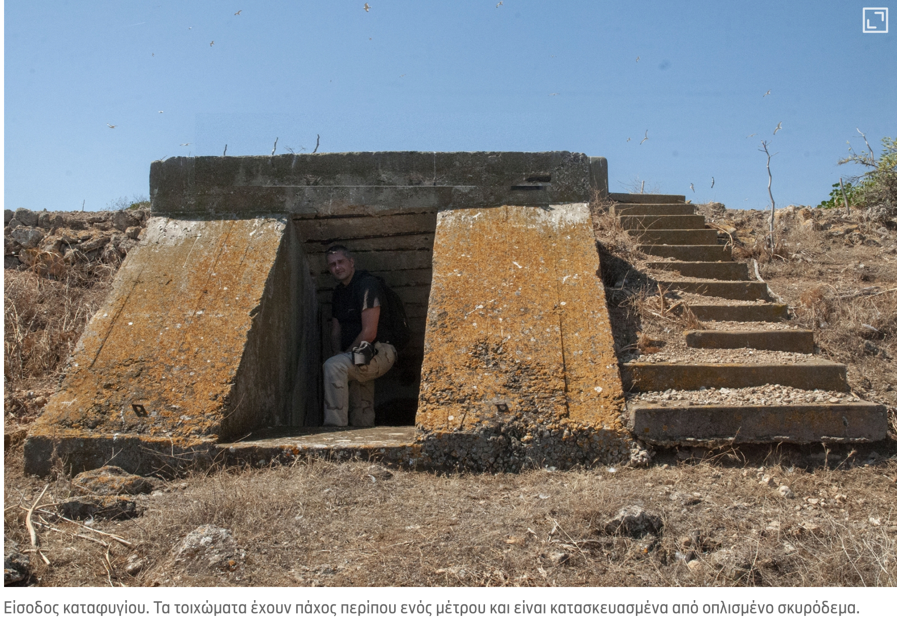
Εισόδος καταφυγίου. Τα τοιχώματα έχουν πάχος περίπου ενός μέτρου και είναι κατασκευασμένα από οπλισμένο σκυρόδεμα. [Γιάννης Αρσενιάδης]
